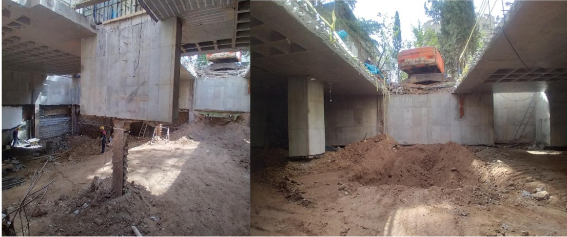
شکل ۱-۱۵ پروژه اندرزگو- الگوی بومی - اسکلت مختلط بتنی فولادی (SRC) - عمق گودبرداری ۱۸ متر.
