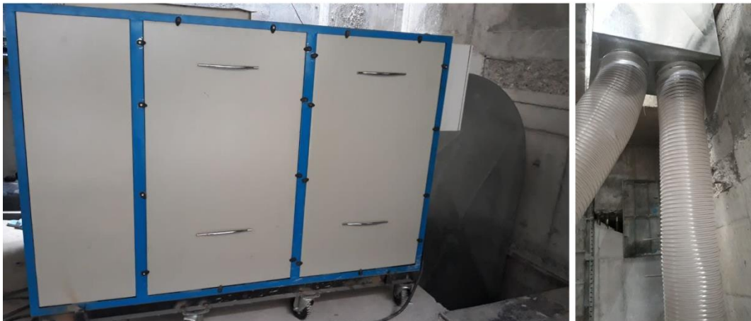
شکل ۳-۱۳۰ نمونه فن استفاده شده برای دهش هوای تازه و کانال به کارگیری شده
