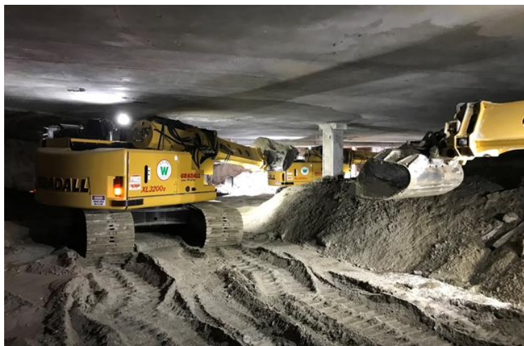
شکل ۳-۷۳ جابجایی خاک در راستای افقی و زیر تراز سقف زیرزمین در روش ساخت بالا-پایین به کمک بیل‌های مکانیکی دارای بازو تلسکوپی افقی.
