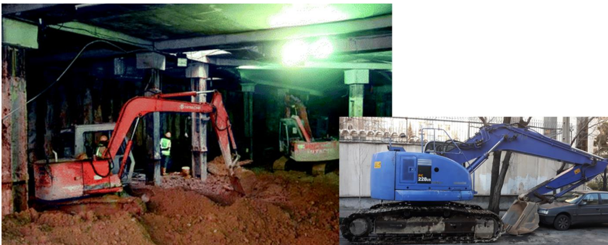
شکل ۳-۷۰ کندن خاک در زیر سقف طبقات زیرزمین و مابین ستون‌های سازه به وسیله بیل مکانیکی با اندازه متوسط در اجرای سازه به روش بالا-پایین
