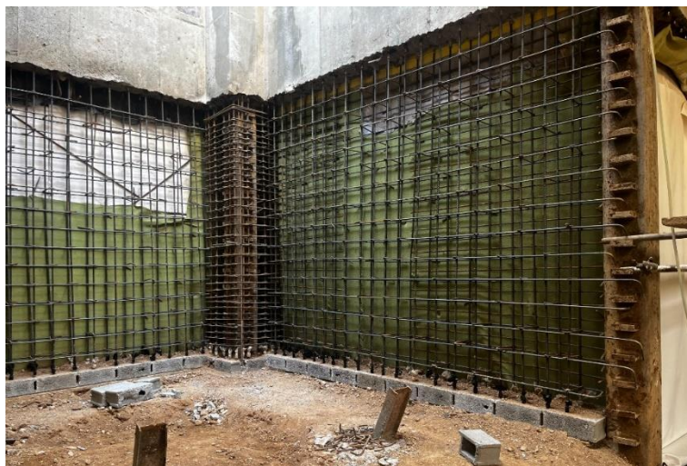
شکل ۳-۱۰۰ شبکه میلگرد دیوار حائل و آماده سازی برای قالب بندی و بتن ریزی.
