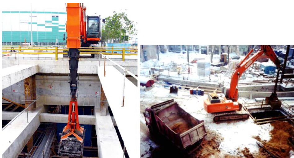
شکل ۳-۷۸ تصاویری از تخلیه خاک به وسیله بیل مکانیکی بازو تلسکوپی از یک پروژه در حال اجرا به روش بالا-پایین. ابعاد کوچک بازشوی ایجاد شده در دیافراگم سقف در تصویر سمت راست مشخص است.
