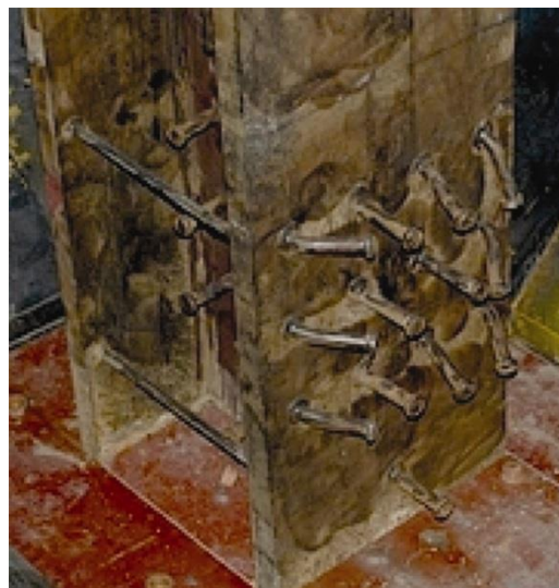
شکل ۳-۳۱ آسیب دیدن گل میخ‌های نصب شده روی ستون پس از عملیات خاک - سیمان چاه و همچنین خاکبرداری.
